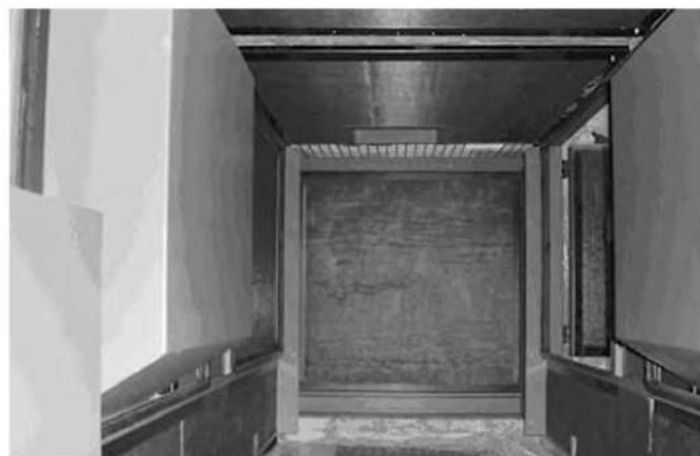
Imagen 3 - INTERIOR DE UN GRUPO ELECTRÓGENO INSONORIZADO
