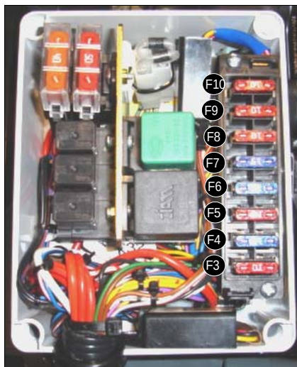
Fig. 42: Caja de fusibles
